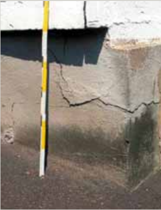
Fraglich: Wurde der Riss in der Gebäude- decke durch eine in der Nähe ausgeführte Horizontalspülbohrung verursacht und wird er sich zukünftig noch vergrößern?
