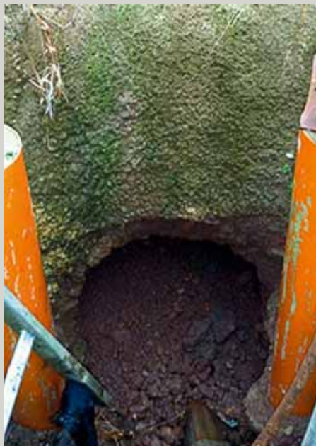
Vorhersehbar: Die Wandung einer Zwischenbaugrube musste mit Spritzbeton gesichert werden, das Bohrloch war zudem verbrochen, nachdem anstatt von angekündigtem Fels Lockergestein angetroffen worden ist
